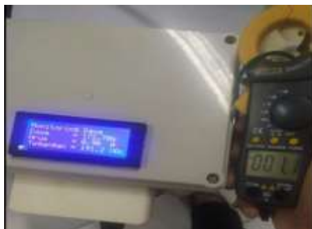
Gambar 9. Pengujian Pengukuran Arus Sistem Monitoring Daya Berbasis IOT dengan Alat Ukur Amperemeter Pada Mesin Genset Biogas
