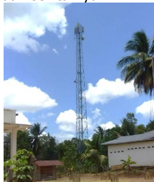
Gambar 12 Menara BTS Desa Pasaka
