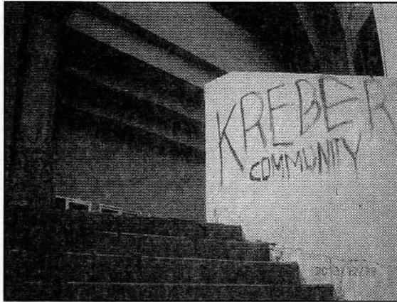
Gambar 1. Warna pada cat bangunan mulai rusak (Sumber: dokumentasi pribadi, 2013)
