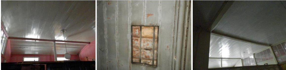
Gambar 17. Foto eksisting plafon Sumber: Dokumentasi Pribadi, 2022
