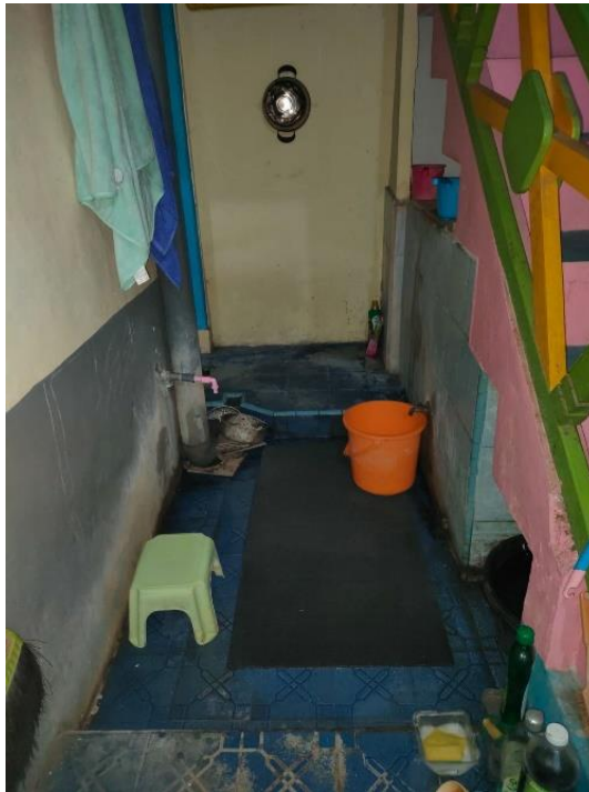
Gambar 5. Kondisi Lantai Ruang Cuci yang Licin dan Dapat Membahayakan Orang Tua. Sumber: Observasi, 2023
