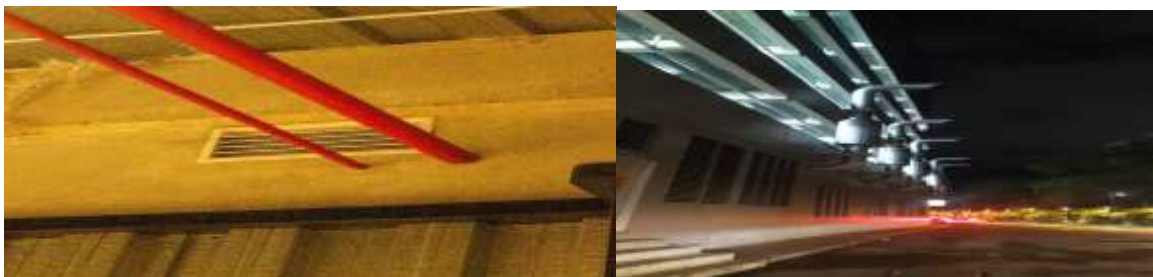
Gambar 10. Penggunaan AC Central dan Cerobong Asap (Sumber: Dokumentasi Pribadi, 2022)
